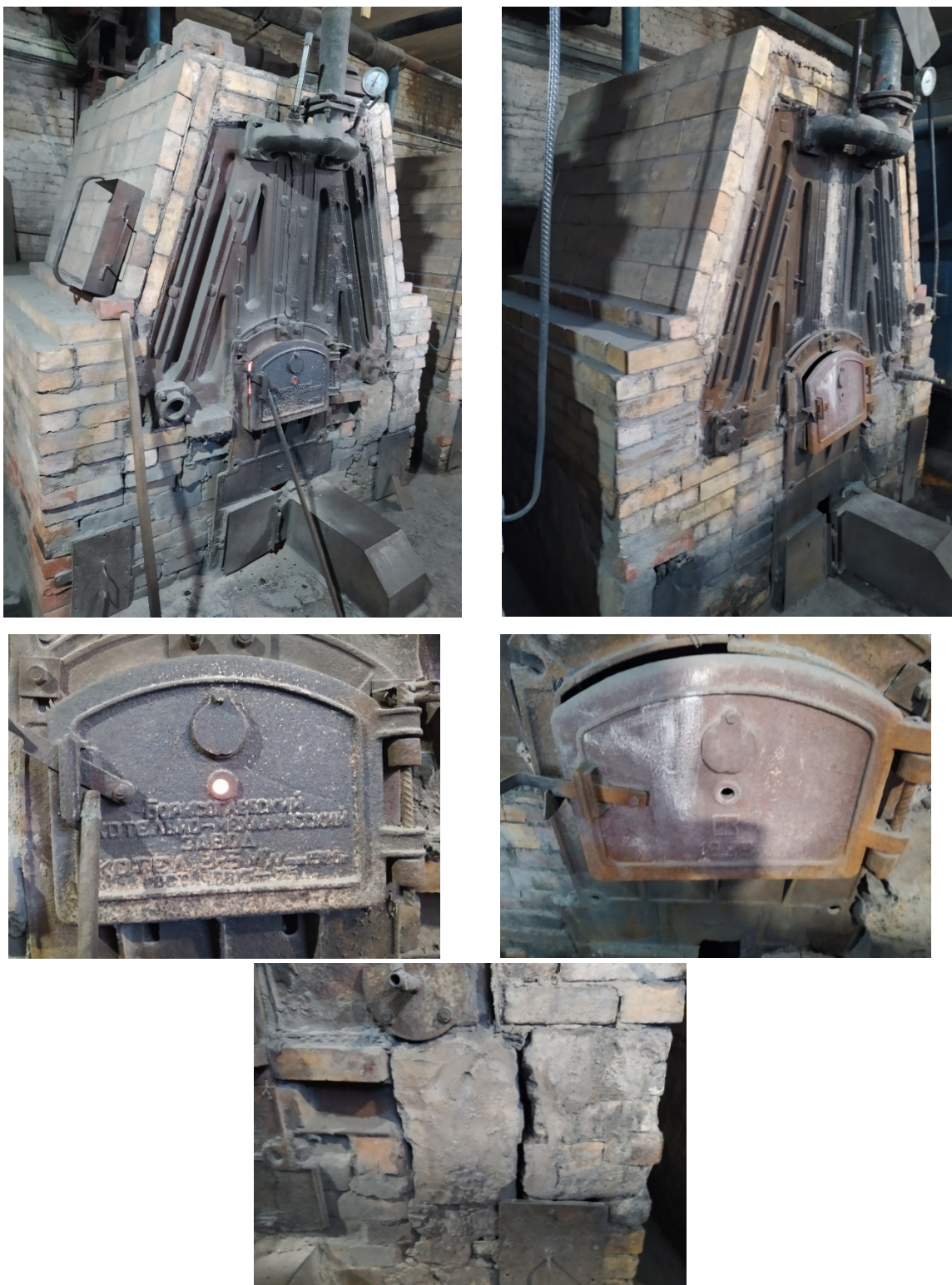
Рисунок 1.72 – Внешний вид водогрейных котлоагрегатов:
