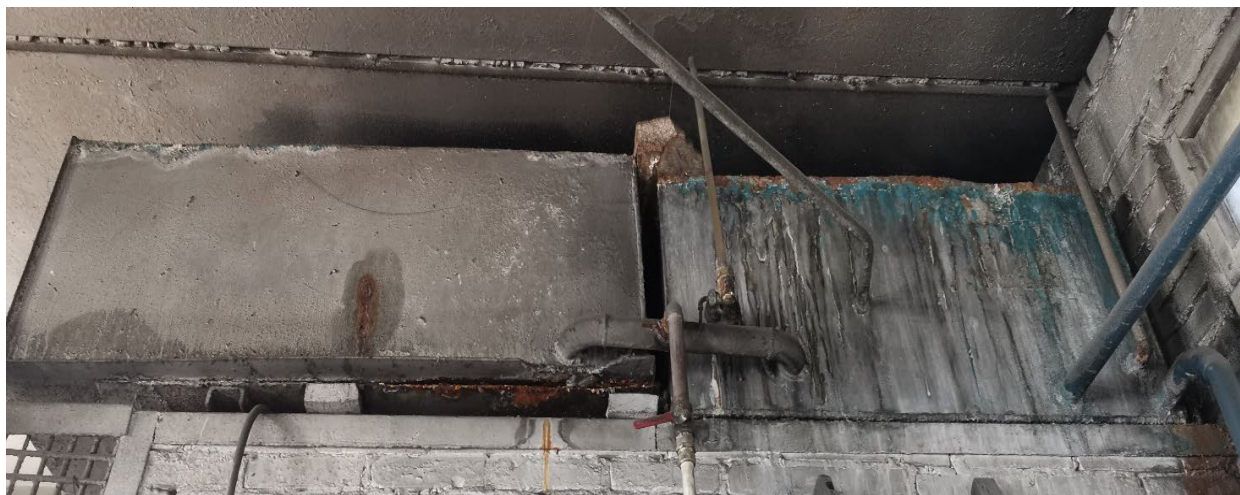
Рисунок 1.69 – Внешний вид баков запаса холодной воды
