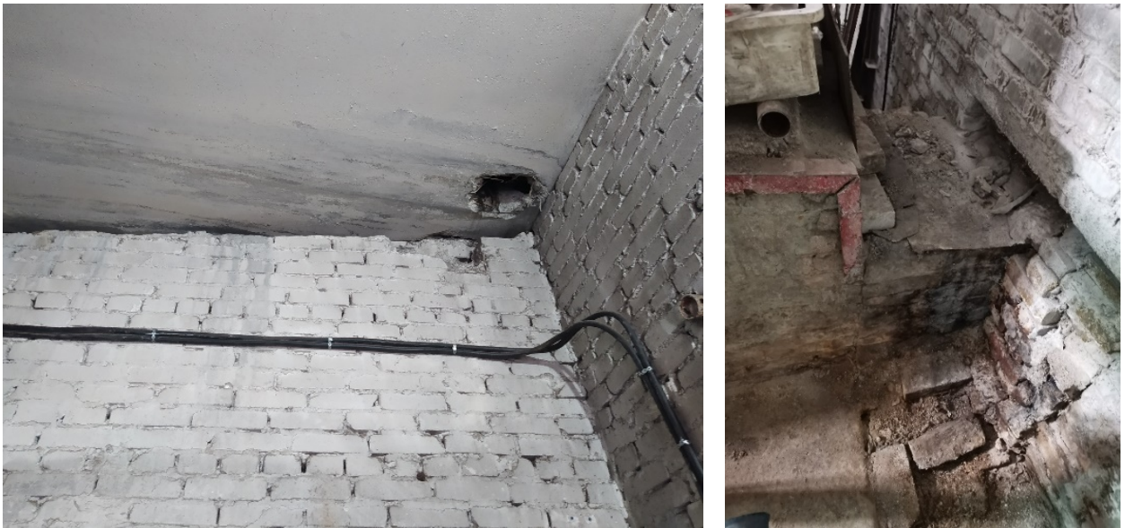
Рисунок 1.54 – Состояние внутренних ограждающих конструкций котельной (г. Приозерск, ул. Цветкова, 43а)
