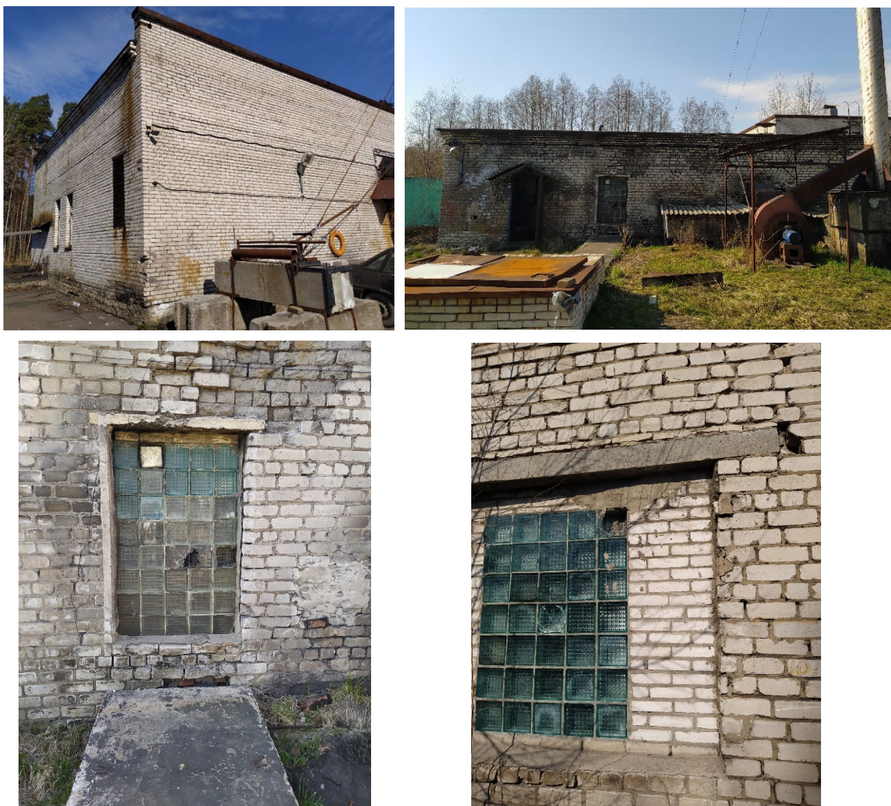
Рисунок 1.58 – Общий вид и состояние наружных конструкций здания котельной (г. Приозерск, Ленинградское шоссе, 63)
