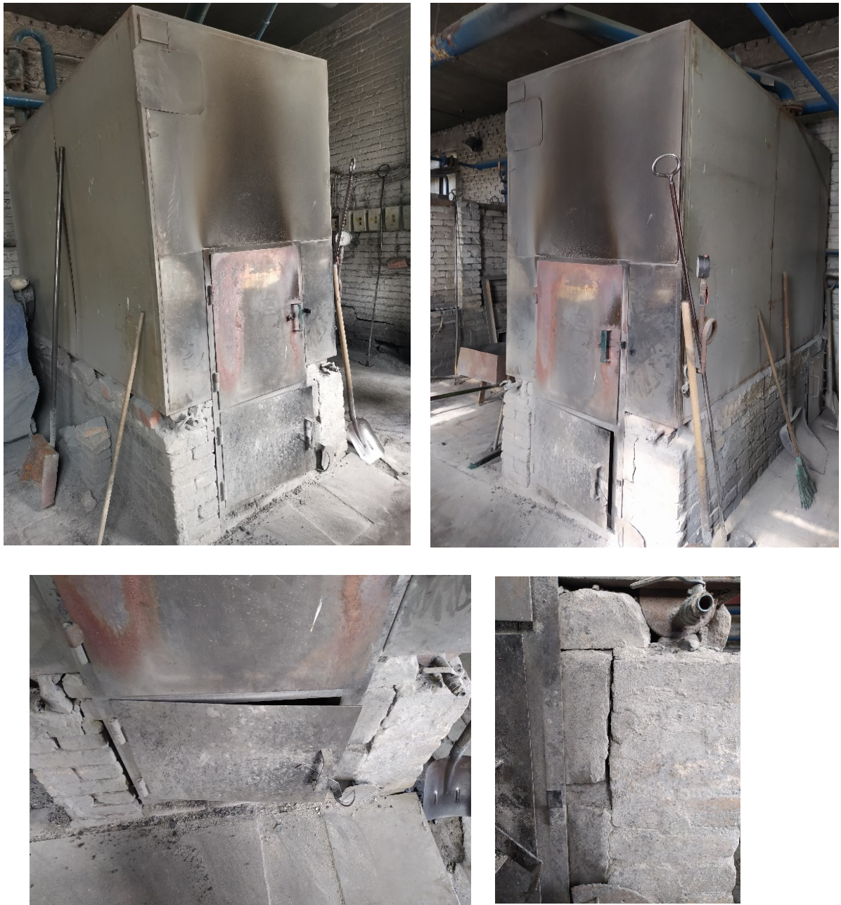
Рисунок 1.66 – Внешний вид водогрейного котлоагрегата Луга-Лотос КВР-1,5 в легкой обмуровке, ст. № 2: нарушение целостности конструкции котлоагрегата
