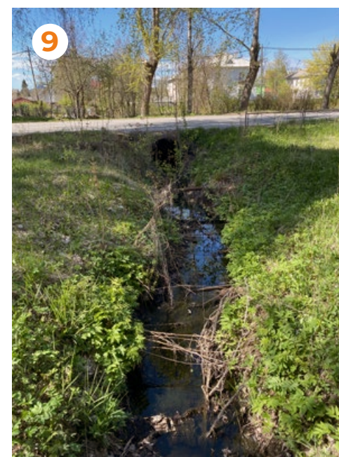
9 Канавка. Требуется очистить и укрепить склоны.
