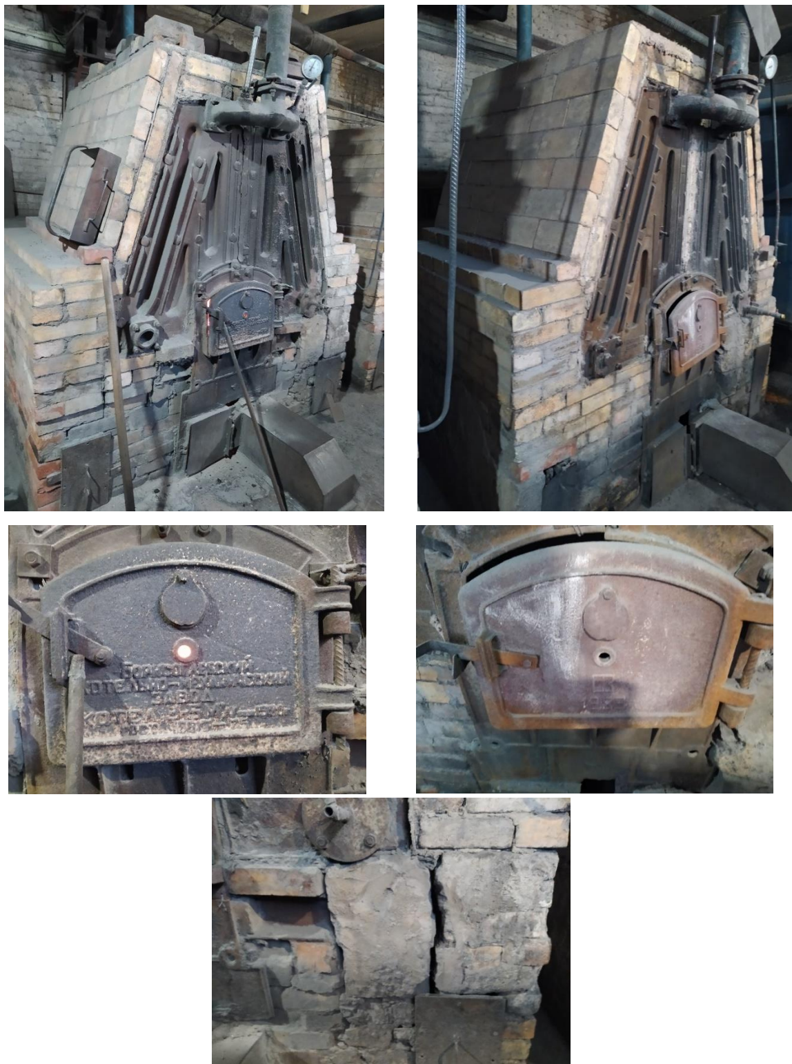
Рисунок 1.72 – Внешний вид водогрейных котлоагрегатов: Универсал-6, зав. № 56, ст. № 1; Универсал-6, зав. № 58, ст. № 2
