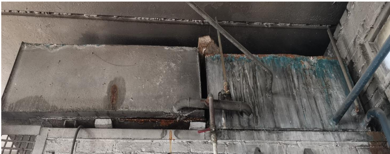
Рисунок 1.69 – Внешний вид баков запаса холодной воды
